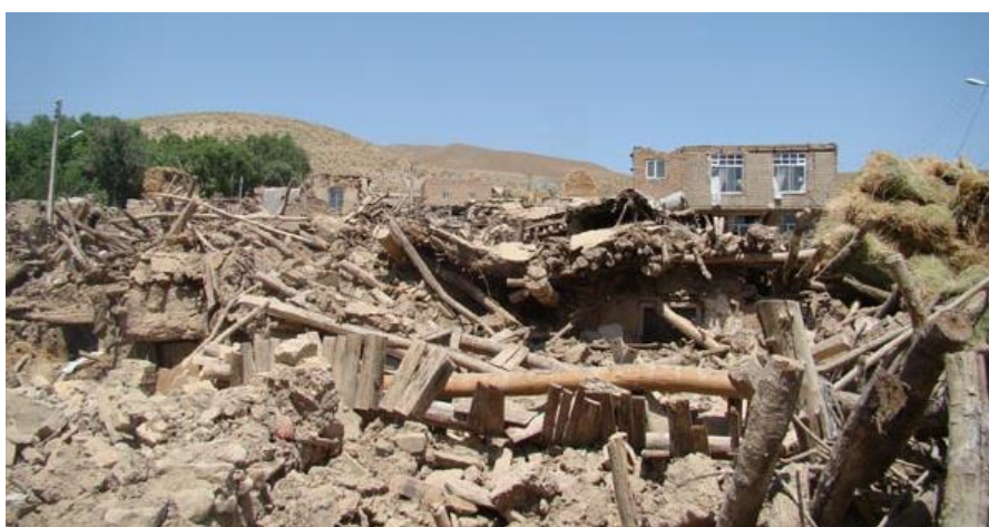
شکل ۵: پسماندهای ناشی از تخریب اماکن روستایی در مناطق زلزله‌زده (۱۴)
